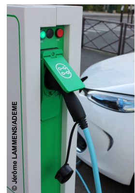
Recharge d'un véhicule électrique
