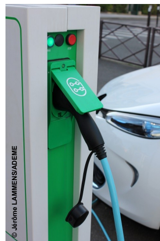
Recharge d'un véhicule électrique
