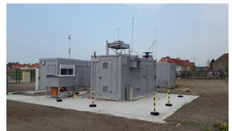
Démonstrateur « injection H 2 dans un réseau de gaz pour alimenter un quartier d'habitation et une chaufferie »
