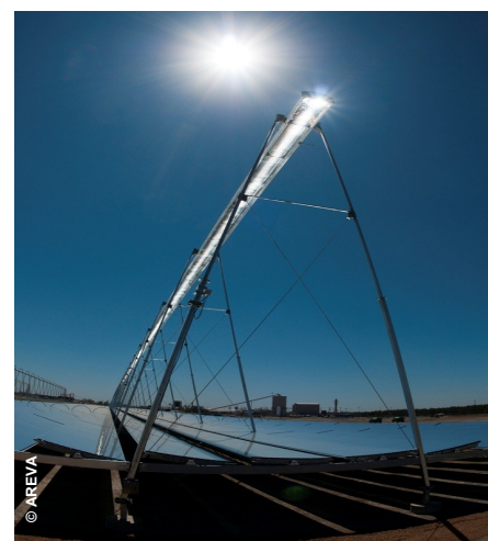
Centrale solaire de Kimberlina installée par AREVA Solar, Bakersfield (Californie)
